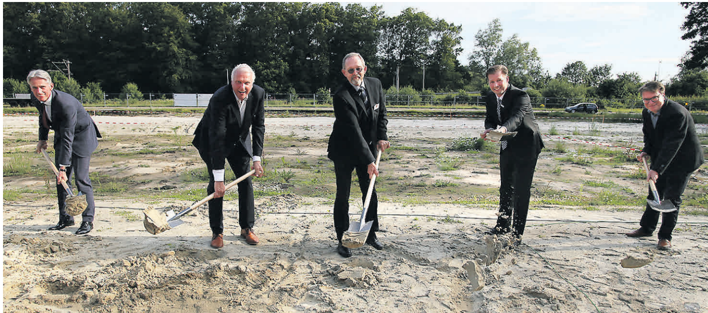
Beim symbolischen ersten Spatenstich auf dem alten Verladegelände (von links): Die GVO-Vorstände Martin Zimmer und Gernold Lengert, Aufsichtsratsvorsitzender Prof. Dr. Dietmar Pfeifer, der stellvertretende Bürgermeister Henning Dierks und Carsten Meyer, Fachbereichsleiter Bauverwaltung
